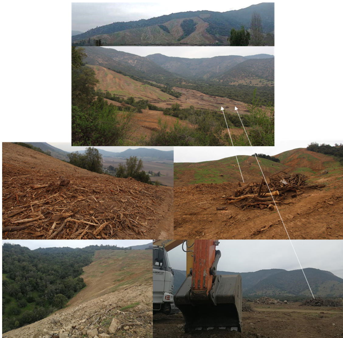
Figura 1. Proceso de tala y eliminación total de bosque esclerófilo para la habilitación de plantaciones de paltos en el sector de Quilicura, Las Cabras Región de O’Higgins, Chile. Fotografías septiembre 2019. Nótese la tala rasa con destronque total mediante maquinaria pesada, con acopio y acumulación de biomasa en decenas de puntos ladera abajo. La magnitud de la eliminación de bosque y biomasa se puede apreciar en el número y tamaño de acopios indicados con las flechas de color blanco.
